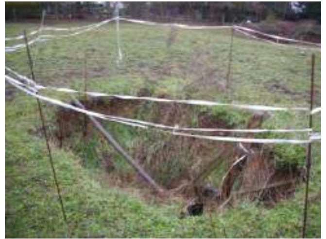
Effondrement - Villevêque, Maine-et-Loire @CEREMA 2015
