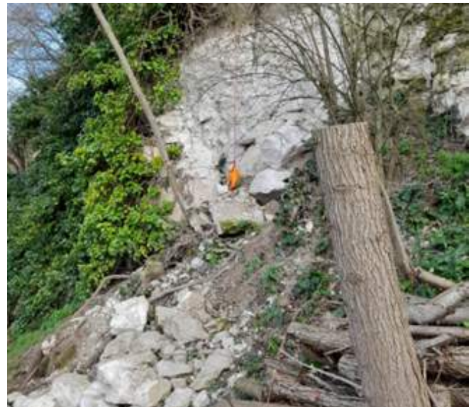
Chute de blocs - Montsoreau, Maine-et-Loire @BRGM, 2024
